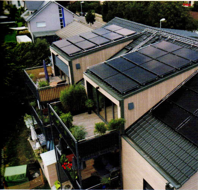
Seit Dezember 2020 versorgt die PVT-Wärmepumpen-anlage sechs Wohnungen mit einer Gesamtfläche von 560 Quadratmetern in Heitersheim bei Freiburg mit Strom und Wärme.
